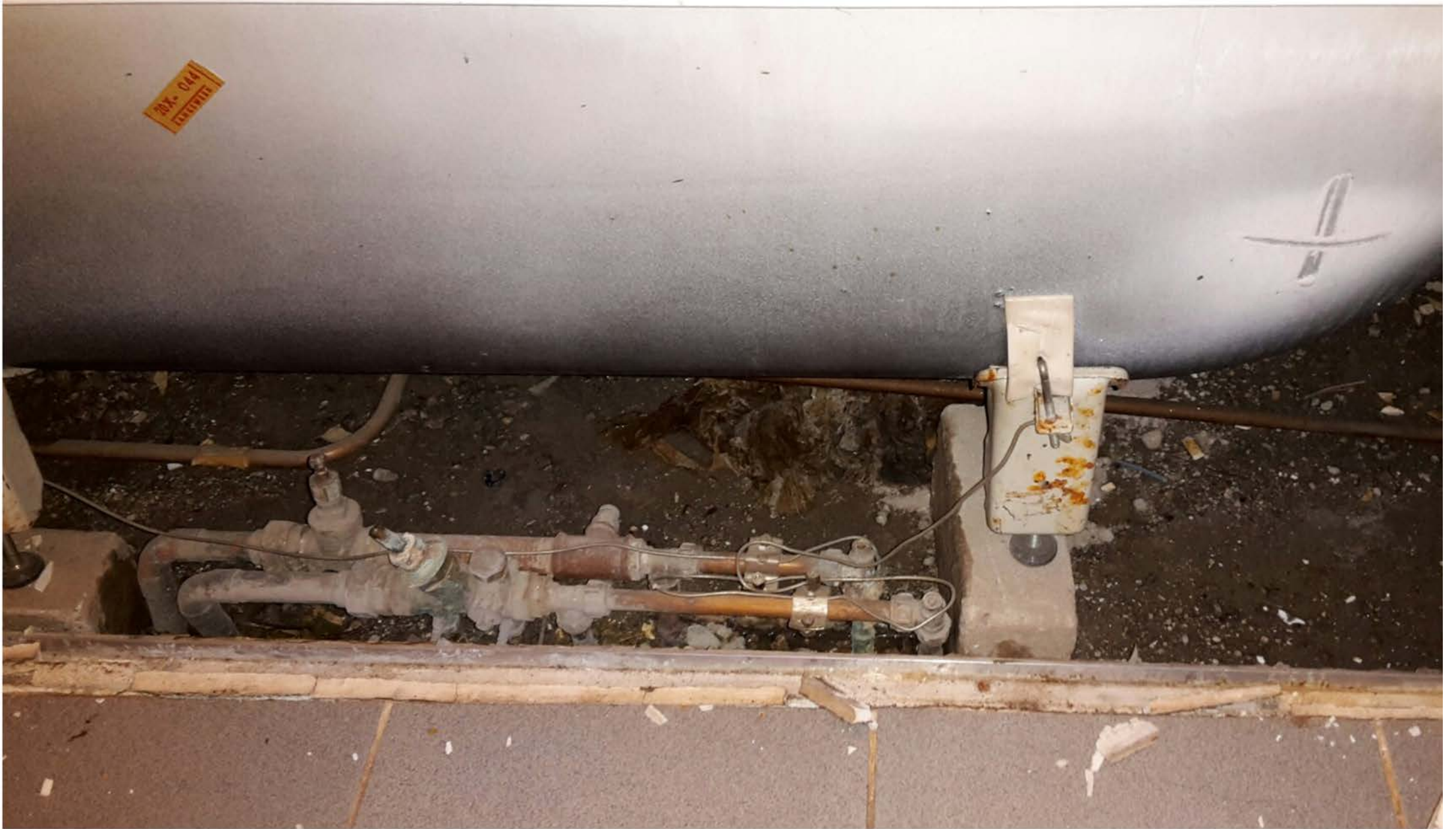
Waterafsluiters, weggewerkt onder het bad
