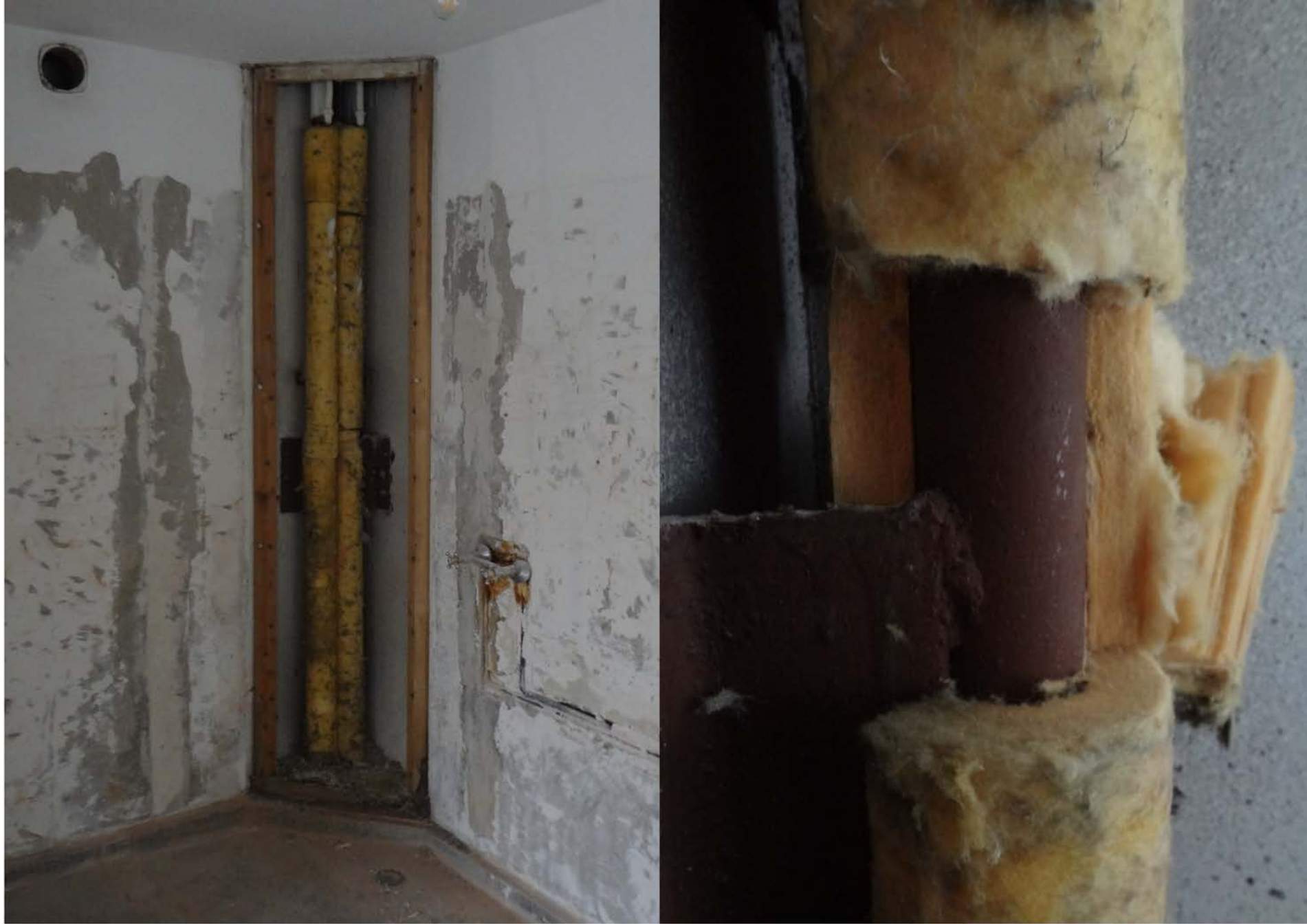
Standleidingen CV in de schacht achter de badkamers
