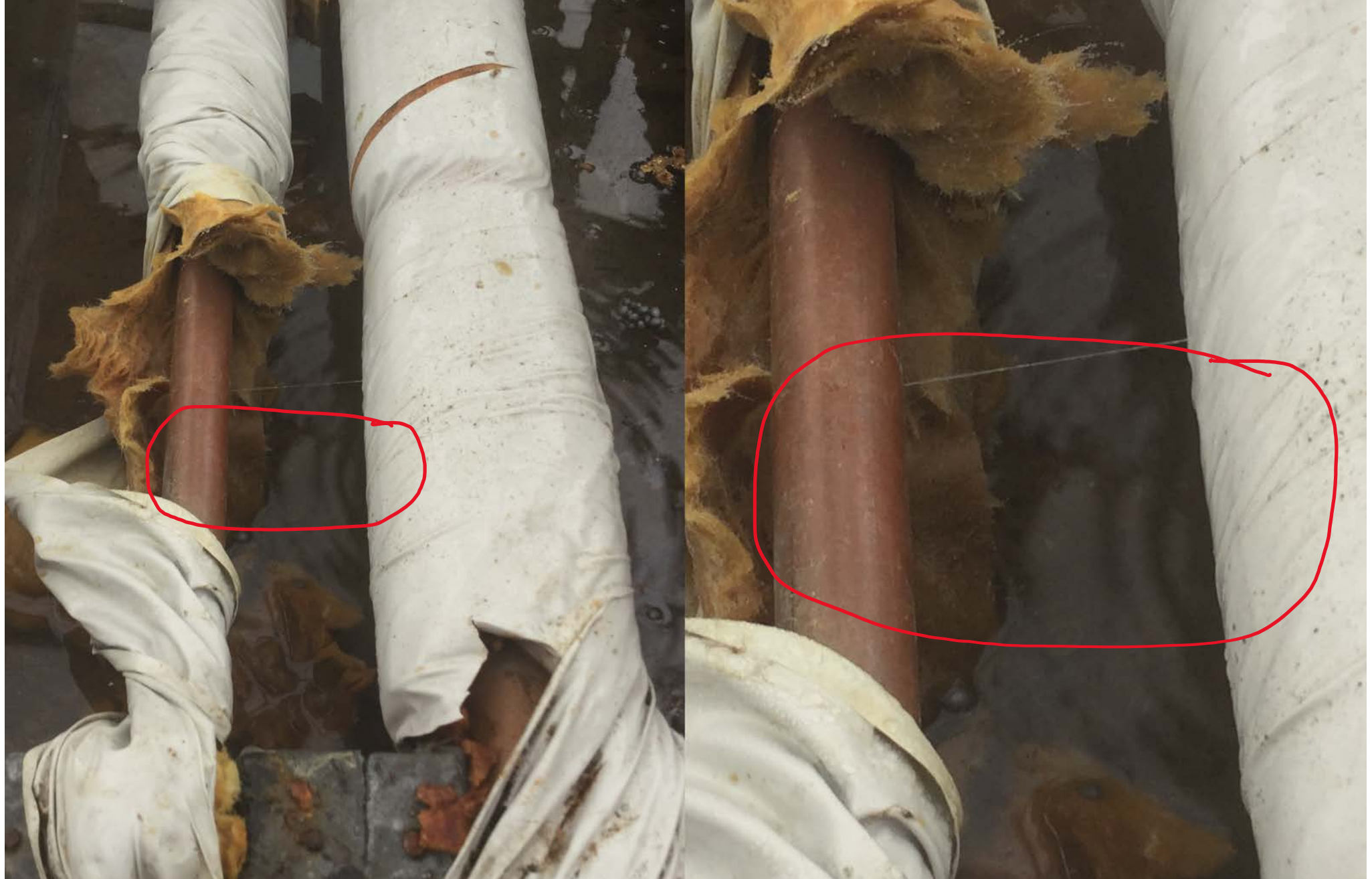
Lekkage in de verbinding tussen de torens t.p.v. de vluchtgang bovendaks
