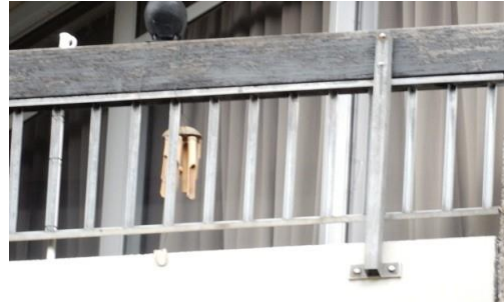
Sterk verweerd, barst en scheurvorming
